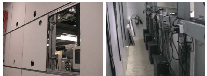
図8 Virtualized Reality の 3D Room の裏側 壁の裏側に CCD カメラが設置されている。CCD カメラは PC に接続され、リアルタイムで動画を取り込める。また、音も同時に取り込めるようになっている。
